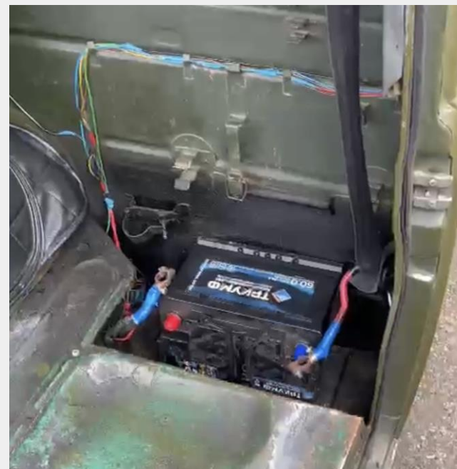
Гелевая батарея ТРИУМФ установлена набок
